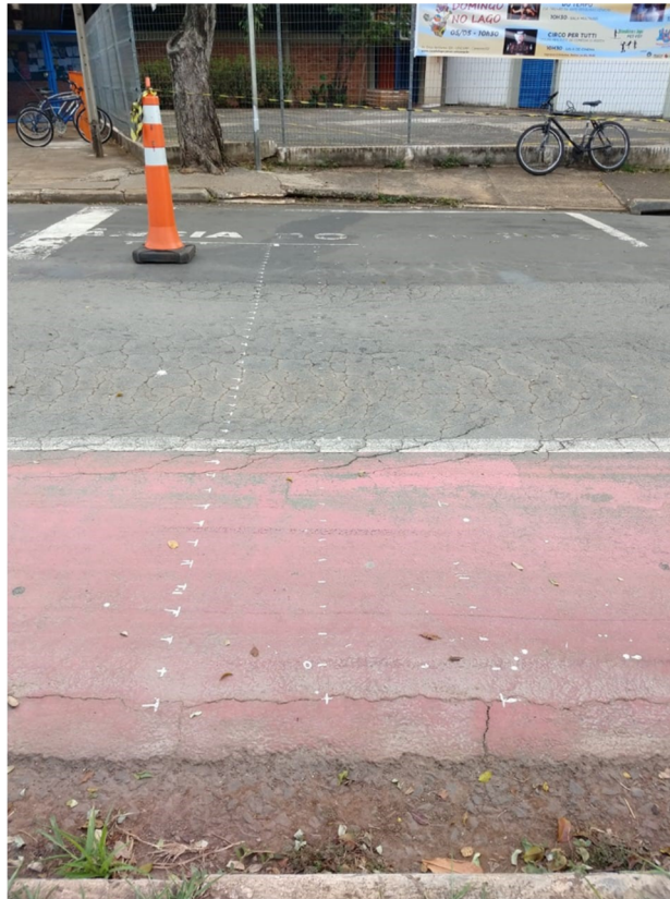
Figura 4.1. Pontos de referência cadastrados na seção transversal com afundamento por consolidação em trilha de roda.
