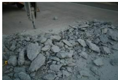
Figura 2- Desagregação superficial da placa
